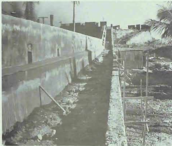
Detalles de lienzos de murallas con su camino de ronda, en el baluarte de Santa Bárbara durante y después de los trabajos efectuados.
