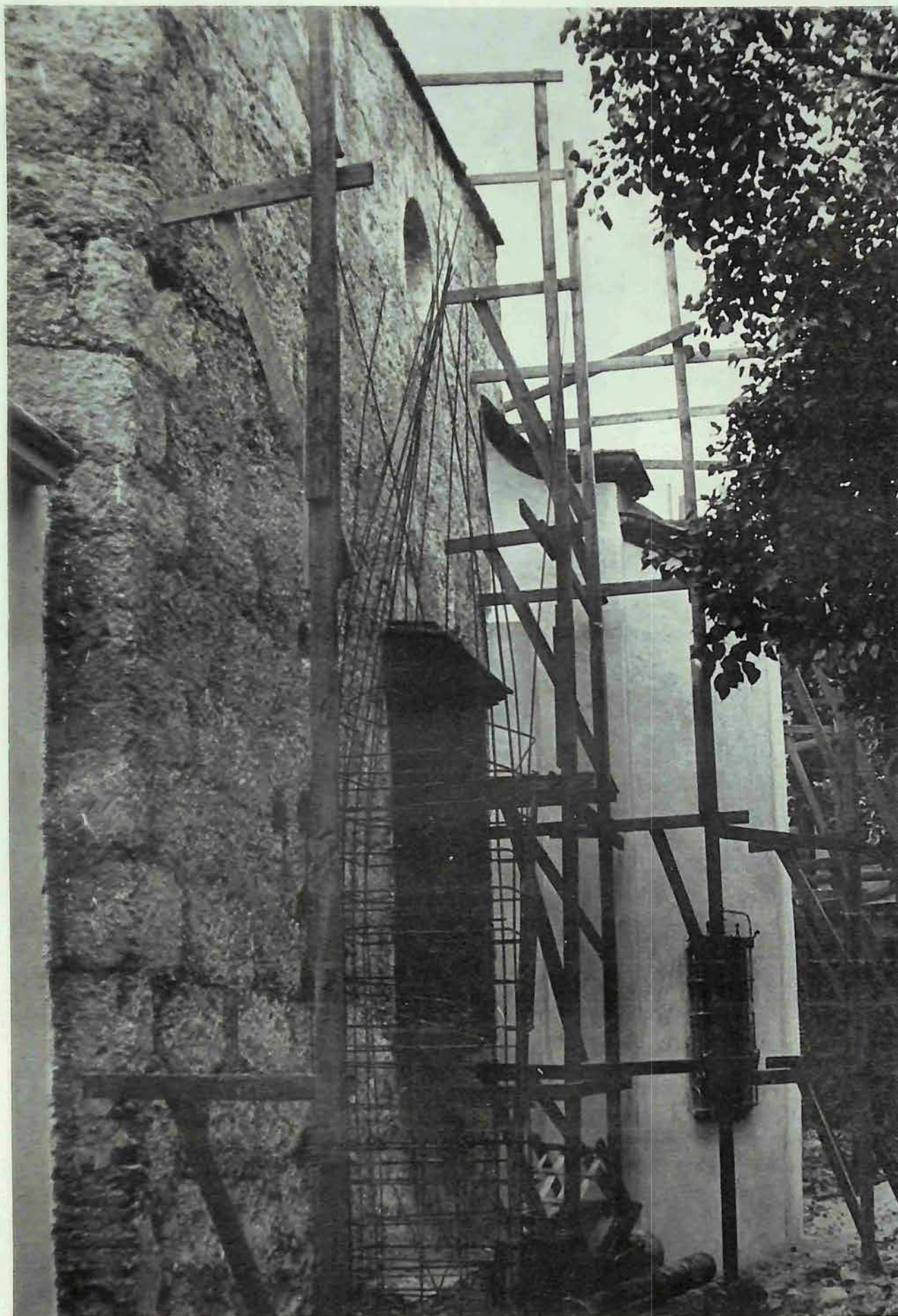
Construcción en proceso de un contrafuerte de hormigón armado en la parte Norte del ábside, de la Iglesia del Carmen.
