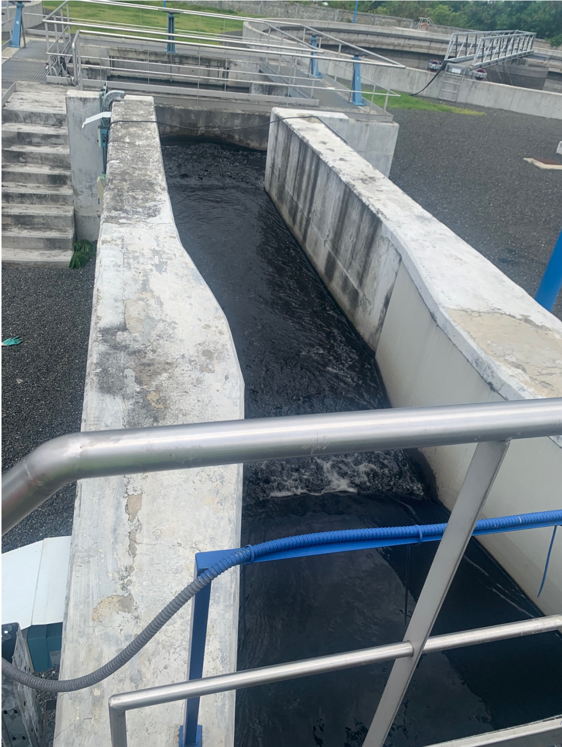
Ilustración 20: Canaleta Parshall seguida de una cámara de repartición en la Planta de Tratamiento de Aguas Residuales La Zurza
