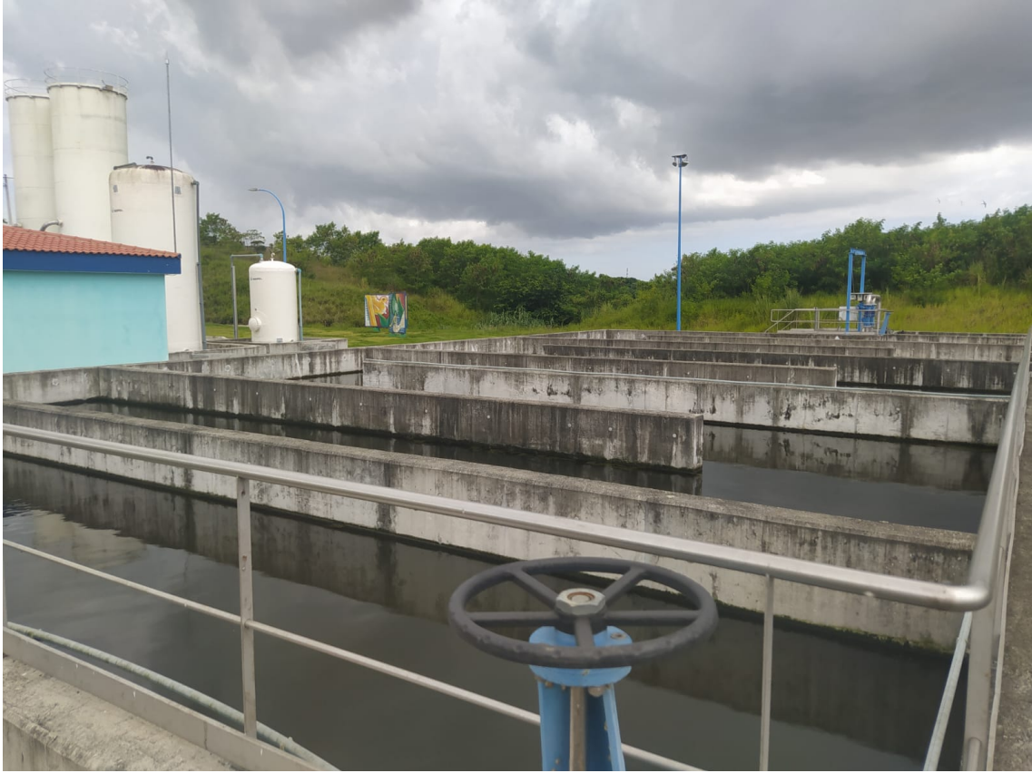
Ilustración 21: Canal de cloración en la Planta de Tratamiento de Aguas Residuales La Zurza
