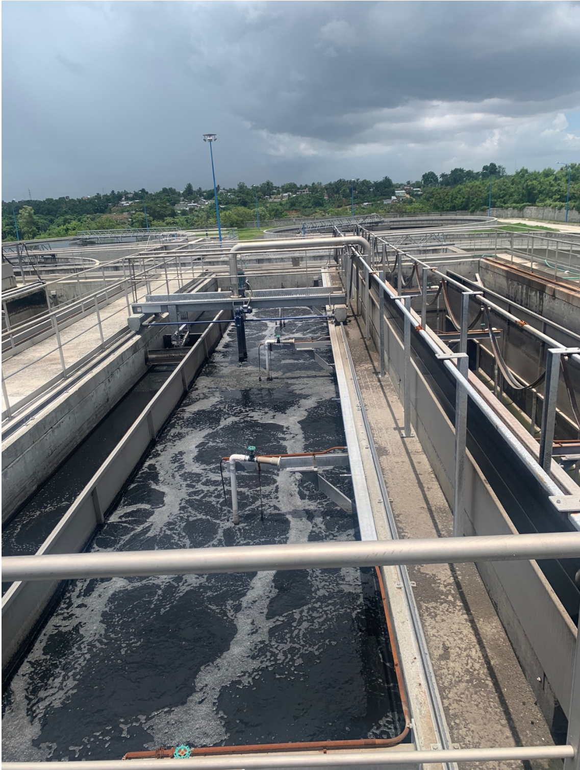
Ilustración 19: Imagen de un desarenador horizontal en la Planta de Tratamiento de Aguas Residuales La Zurza
