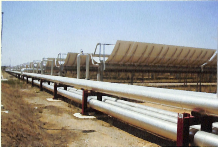
Placas solares en la planta Termosolar en les Borges Blanques, proyecto de referencia que combina la utilización de energía solar, biomasa forestal y biogás para la producción de energía eléctrica.
