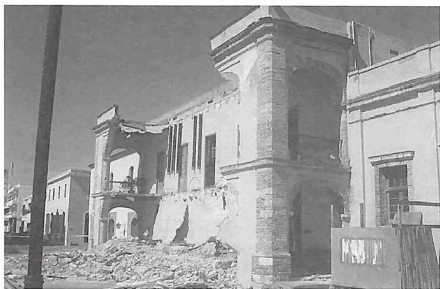
Fachada del Palacio de Borgellá, antigua Casa de Diego de Herrera, hoy sede del Patronato de la Ciudad Colonial de Santo Domingo, después del derrumbe de su arcada al paso del huracán Georges.
