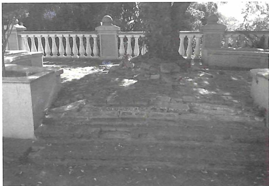
Estado de deterioro en que se encontraba la plaza en su extremo oeste. Inicio del proceso de reparación con el levantamiento de los pisos y corte de raíces.
