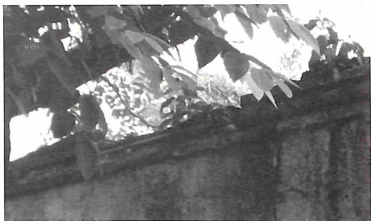
Arbustos que fueron eliminados de las cornisas previamente a su reparación e integración de los ladrillos faltantes.
