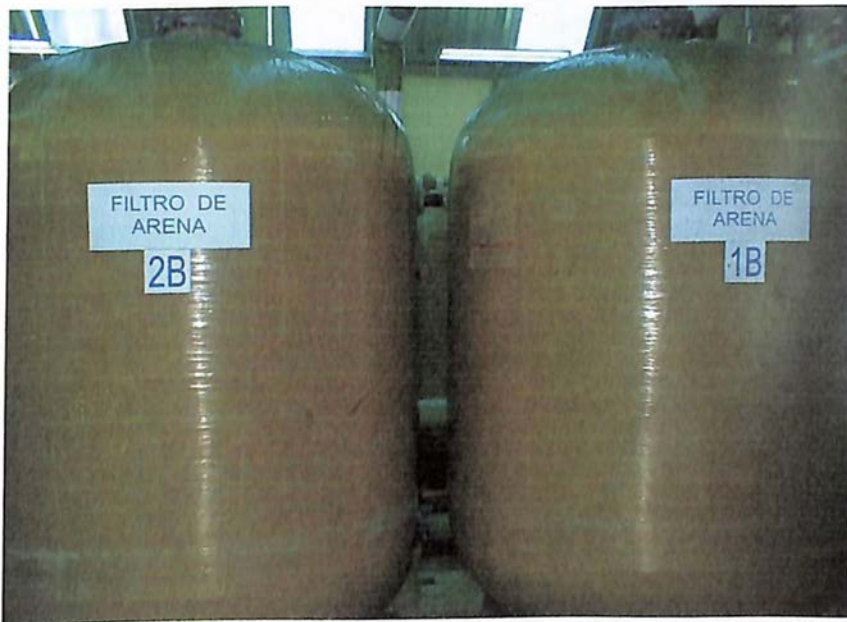
A2: Filtros de Arena
