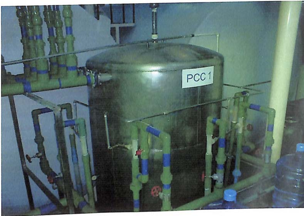
A7: Tanque de Ozono. Punto Crítico de Control No.1
