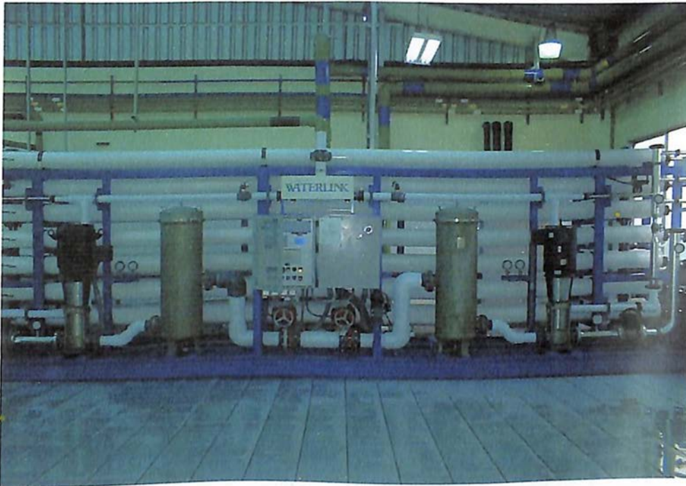
A5: Sistema de Osmosis Inversa
