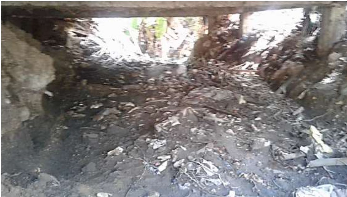
Ilustración 14. Foco de Contaminación
