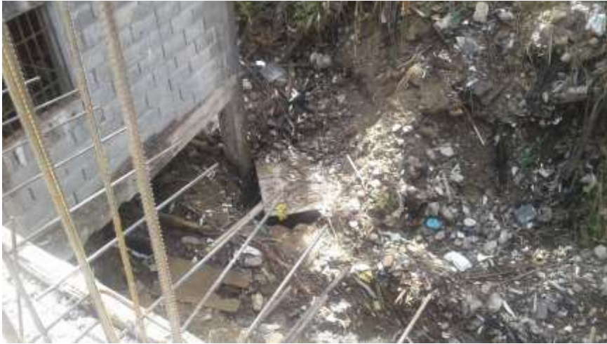
Ilustración 11. Foco de Contaminación
