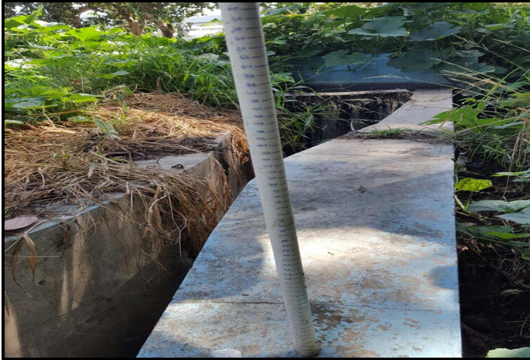
Figura 6: Tubo pvc 3/4" de diámetro y 1.20 metros de altura para aforamiento. Fuente: Planta de Tratamiento de Aguas Residuales, Constanza, Propia, 2016.
