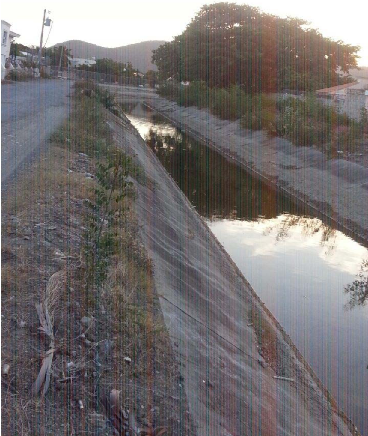
Ilustración 42. Canal Marcos A. Cabral con escasez de agua.
