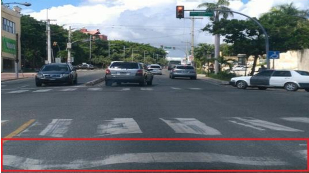
Observacion de via deformada en la Av. Maximo Gomez con Av. Jose Contreras
