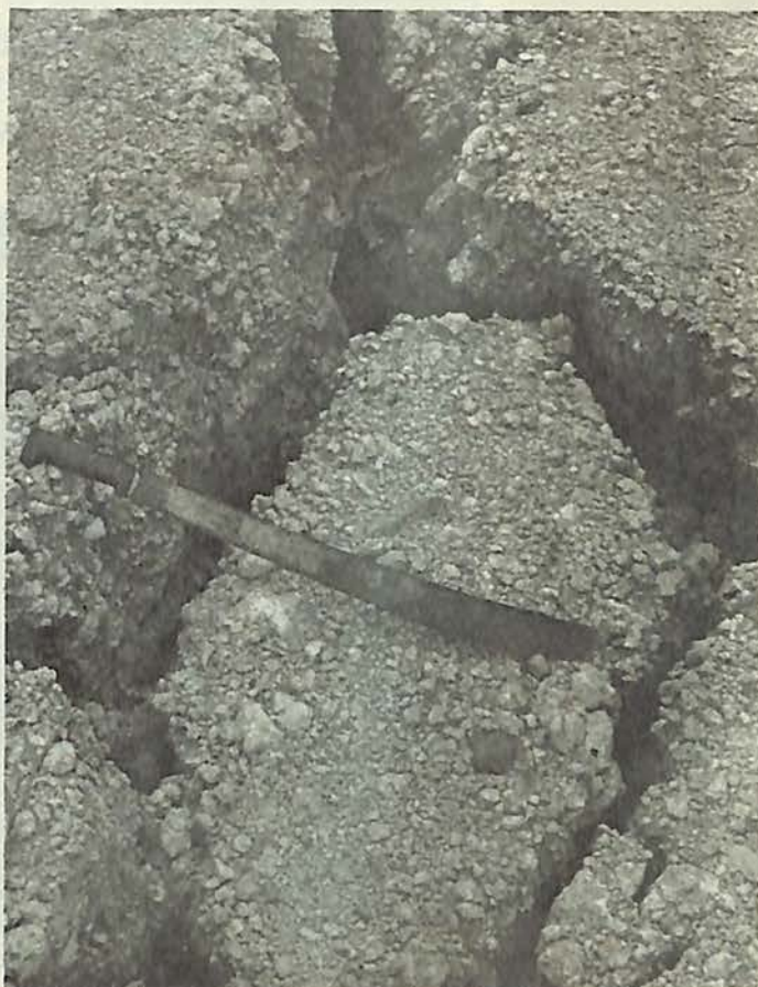
Fig. 14 Agrietamiento del suelo en los alrededores de la Tienda de Consumo. Palma Picada.
