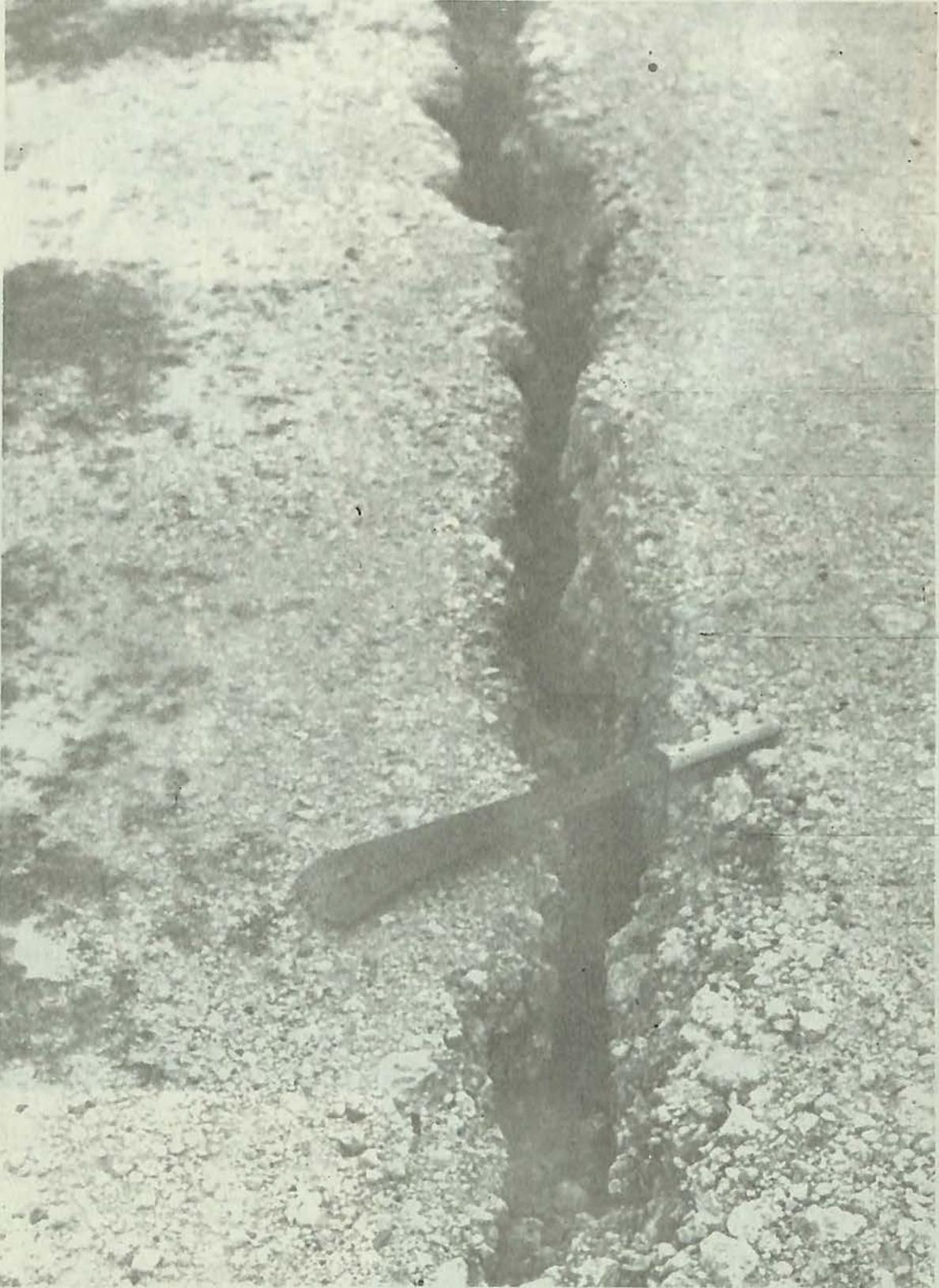
Fig. 8. Grieta en la carretera, frente a la laguna. Palma Picada.
