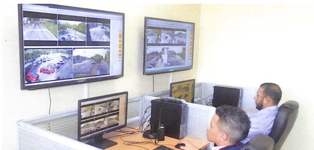
Sala de Control de TV por Circuito cerrado
