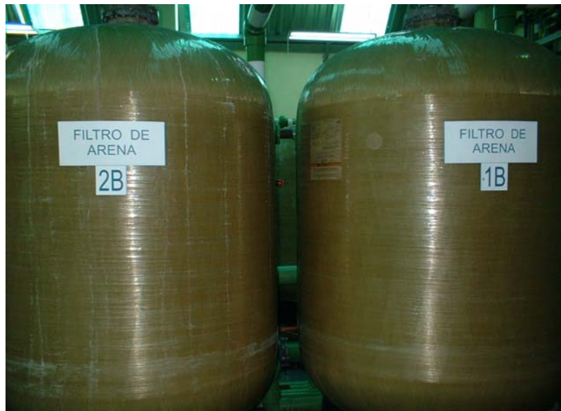
A2: Filtros de Arena
