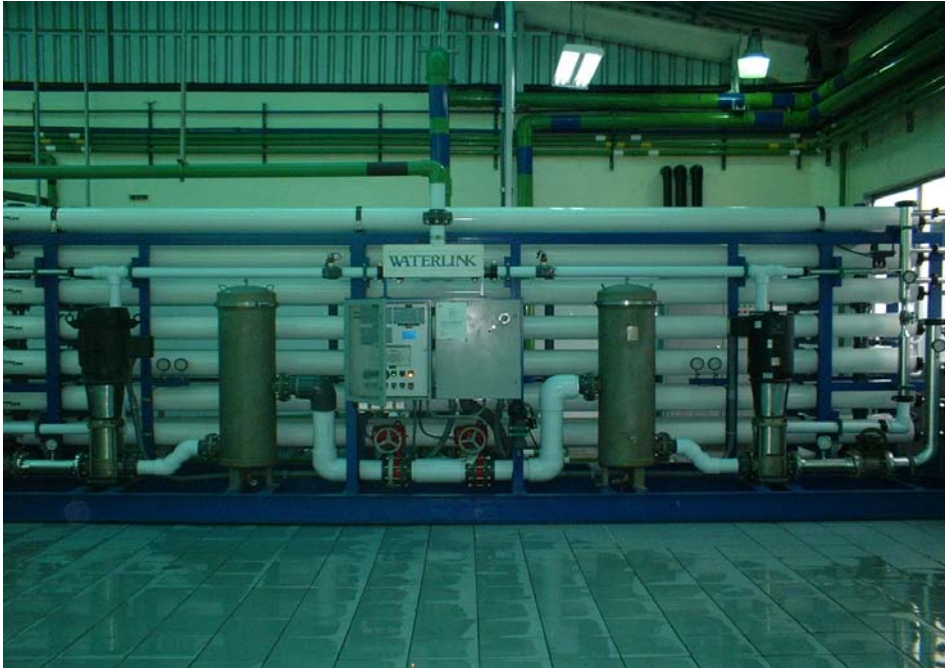
A5: Sistema de Osmosis Inversa
