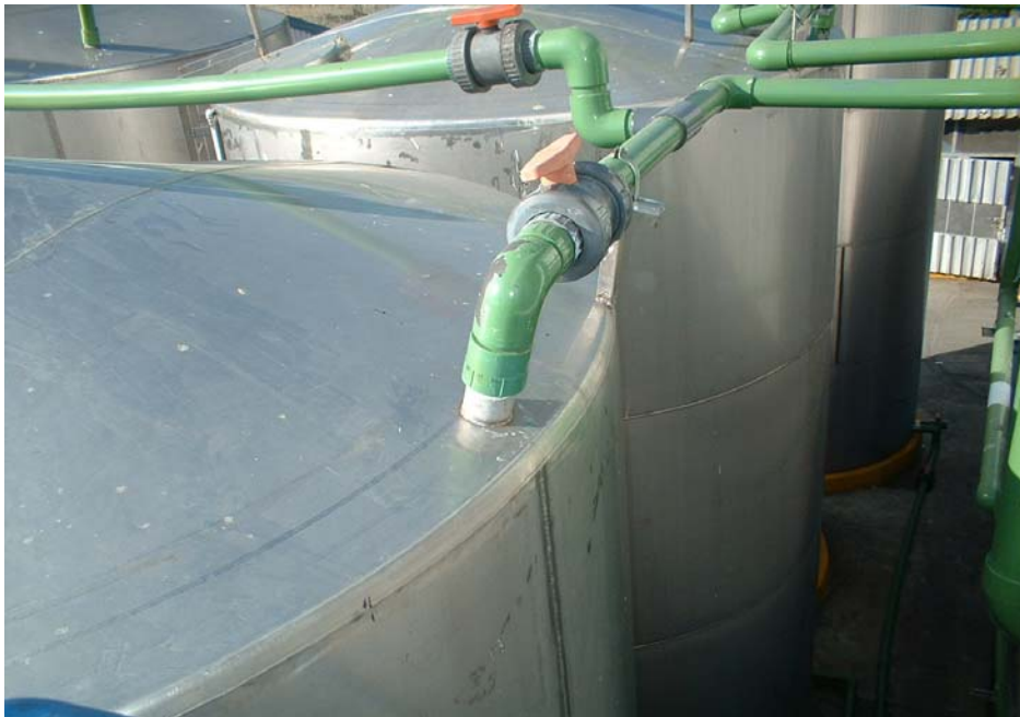
A6: Tanques de Almacenamiento de Agua
