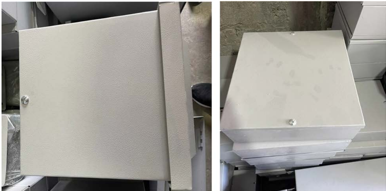
Ilustración 29. Caja eléctrica terminada y pintada
