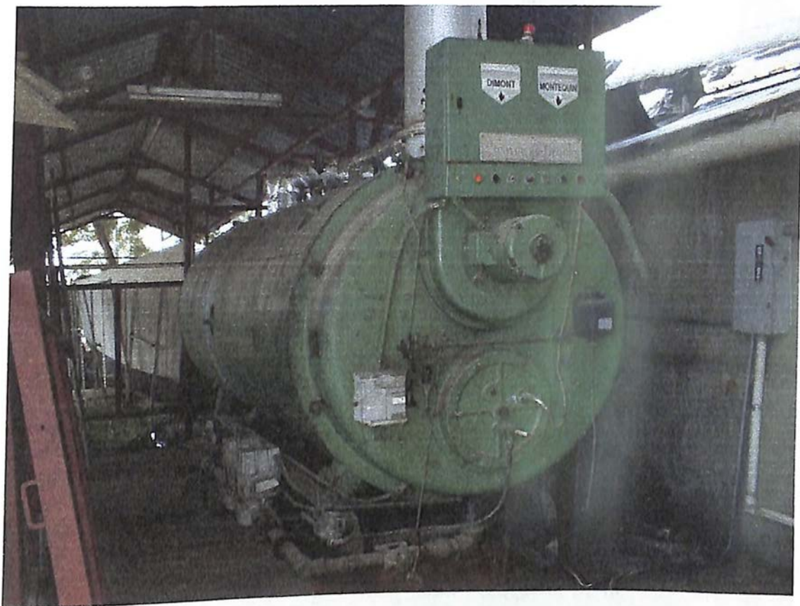
Caldera de gas propano
