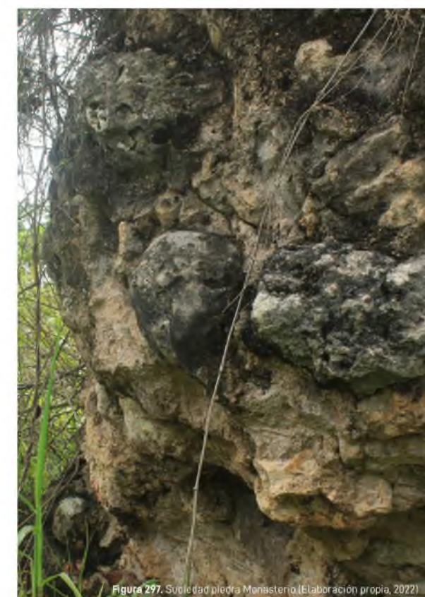
Figura 297. Suciedad piedra Monasterio (Elaboración propia, 2022)
