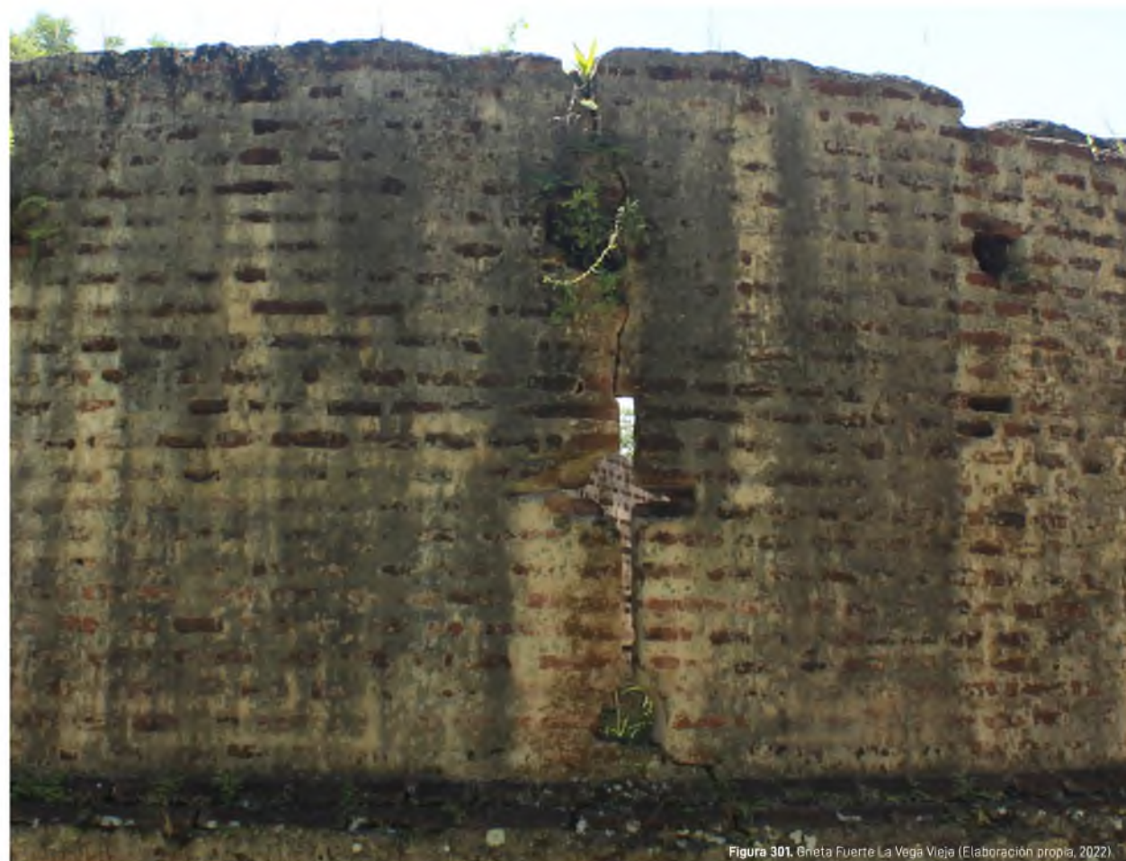
Figura 301. Grieta Fuerte La Vega Vieja (Elaboración propia, 2022).
