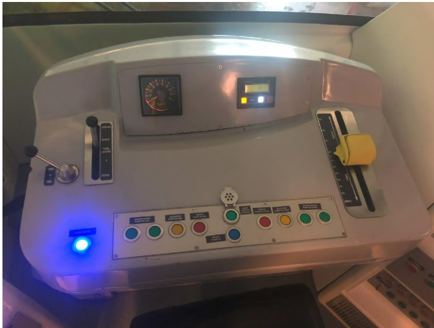
Ilustración 85– Tablero de cabina.
