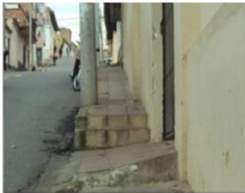
Ilustración 8. Infraestructuras poco accesibles e inseguras.
