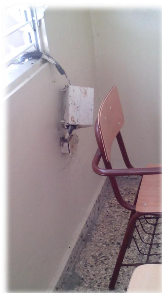
IMAGEN 5 CABLES ELECTRICOS EN MAL ESTADO
