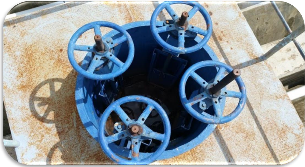
Ilustración 6. Reactor Anaerobio con severos daños hidráulicos Fuente: Propia
