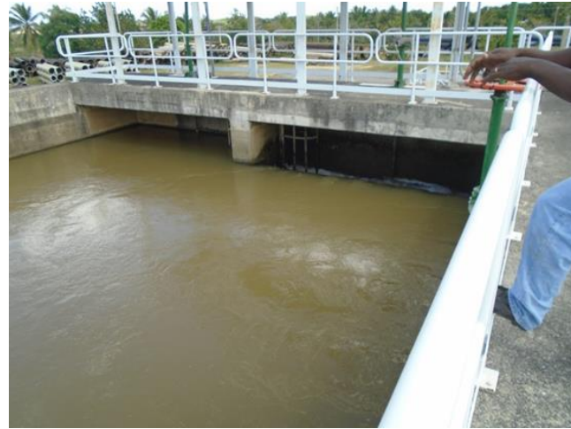
Caja de entrega donde se reparte el caudal a los 2 módulos de la planta.
