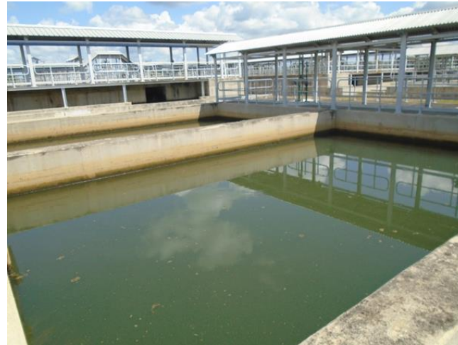
Filtros de flujo descendente.
