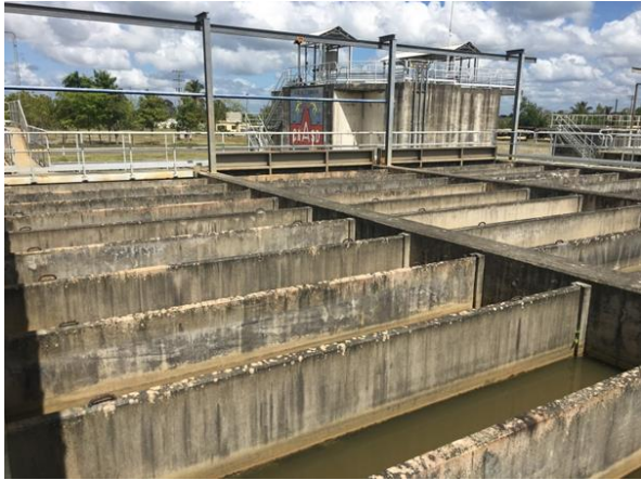
Floculadores de flujo vertical.
