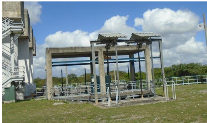
Obra de toma de agua cruda.
