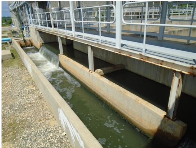
Canal de salida de agua sedimentada
