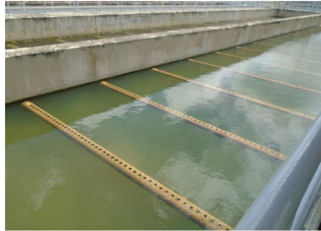
Sedimentadores de agua floculada
