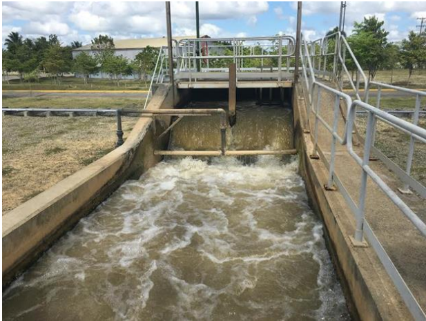
Canal de mezcla Rápida.
