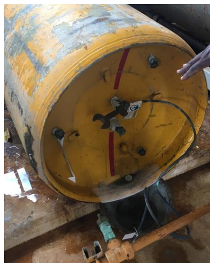
Cilindro de cloro de gas de 2000 lb.
