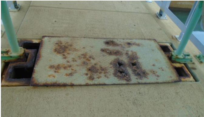
Plancha de metal en mal estado en la P.T.A.P
