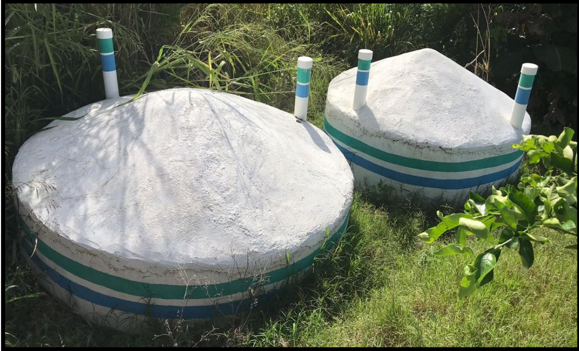
Figura 9. Tanques recolectores. Fuente: (Yaque, 2017)
