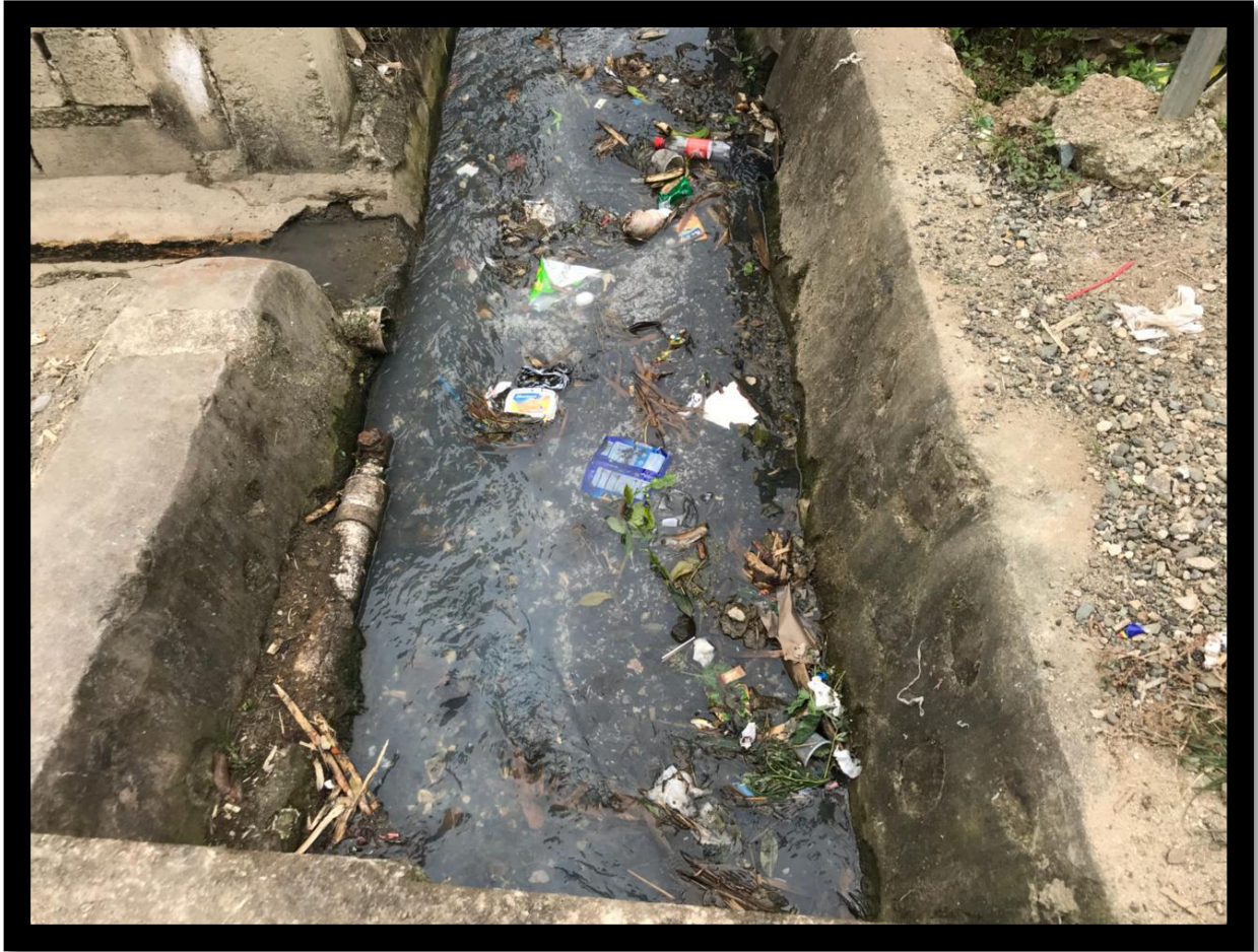
Figura 15. Canaletas que dirigen agua residual y agua pluvial. Fuente: (Propia)
