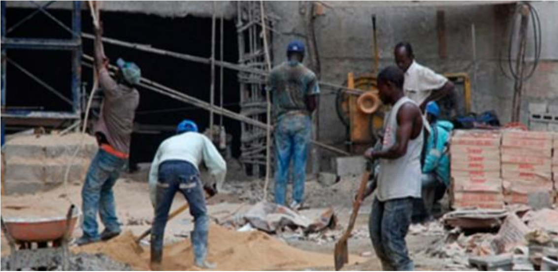
Fotos de Anexos 1, Falta de Equipos de Protección Personal ( Diario Libre)
