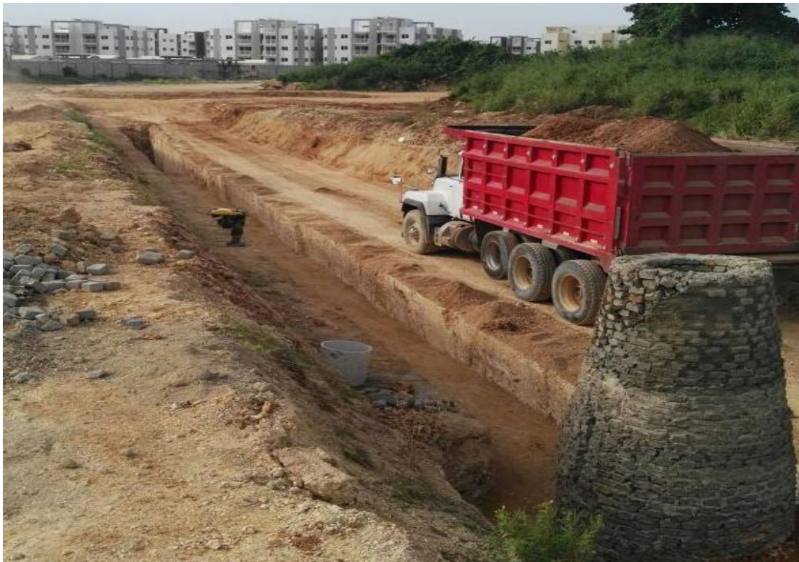
Fotos de Anexos 8. Falta de Señalización en Vía de Acceso (Fuente Propia)
