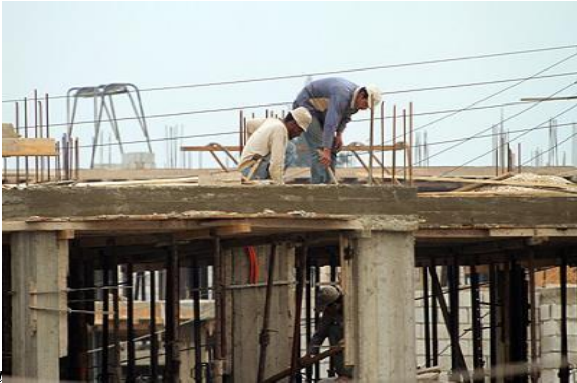
Fotos de Anexos 3, Trabajos en Altura sin Protección ( Tomado de monografías.com)
