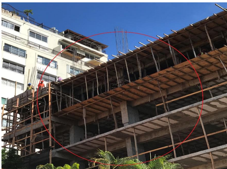
Ilustración 3. Falta de Malla de Protección de Balcón (Fuente Propia)
