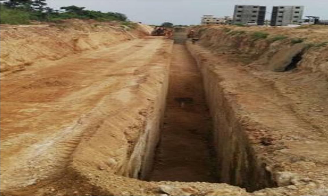
Fotos de Anexos 7. Falta de Señalización en Excavaciones (Fuente Propia)
