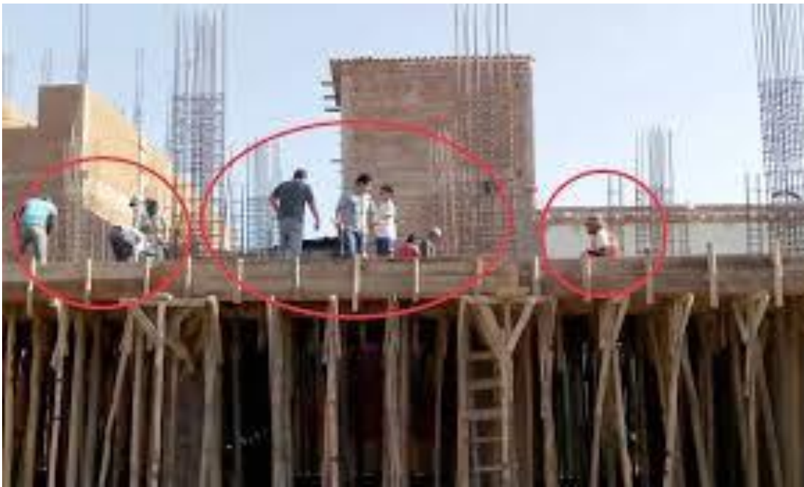
Fotos de Anexos 4, Trabajos en Altura sin Malla de Protección y sin Seguridad de Alturas ( Fuente Propia)
