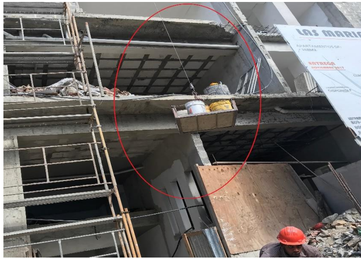
Ilustración 4. Falta de Equipos para manejo de material en altura (Fuente Propia)
