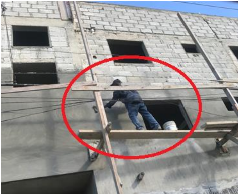
Ilustración 1. Falta de Equipos de Seguridad (Fuente Propia)
