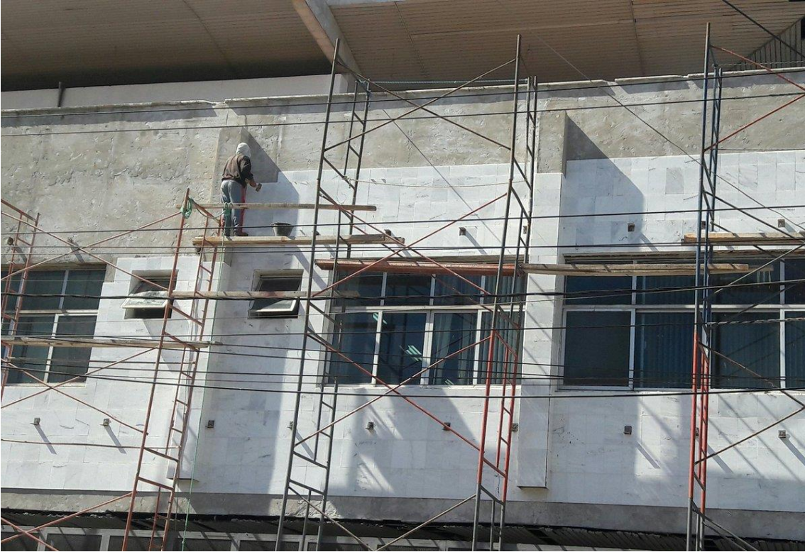
Fotos de Anexos 5. Falta de Arnés para Seguridad de Altura (Fuente Propia)
