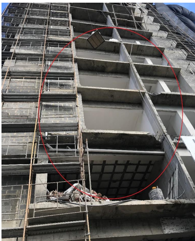
Ilustración 2. Falta de Malla de Protección de Caídas (Fuente Propia)
