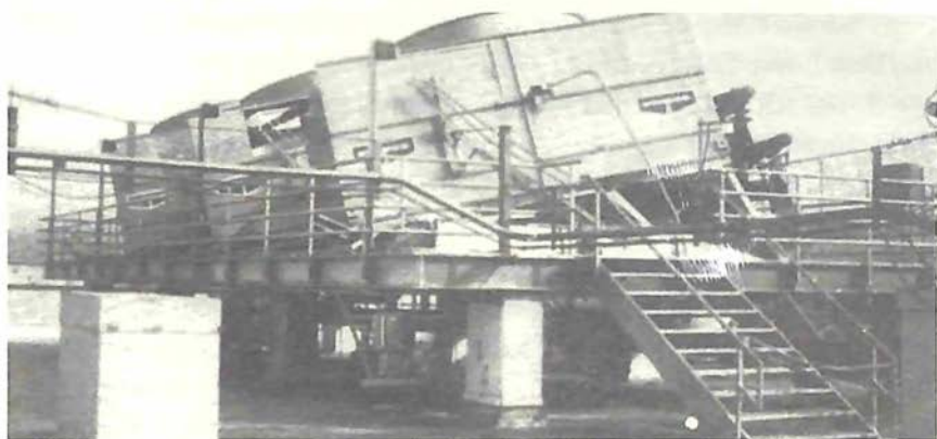
Daños chiller aire acondicionado. Northridge.
