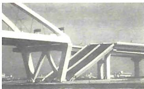
Terremoto Kobe, Japón.
