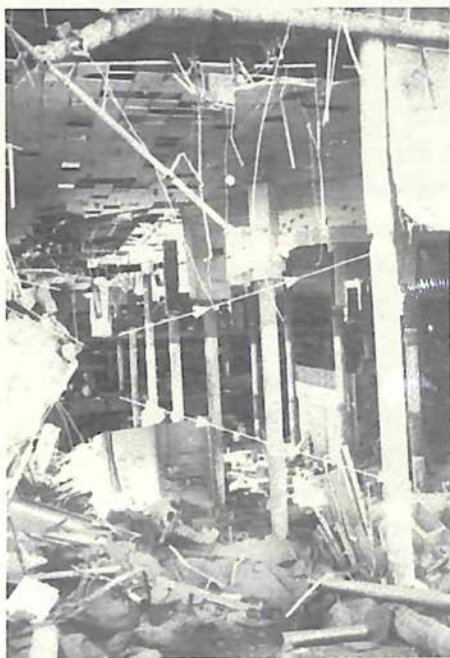
Daños en instalaciones, Northridge, California.
