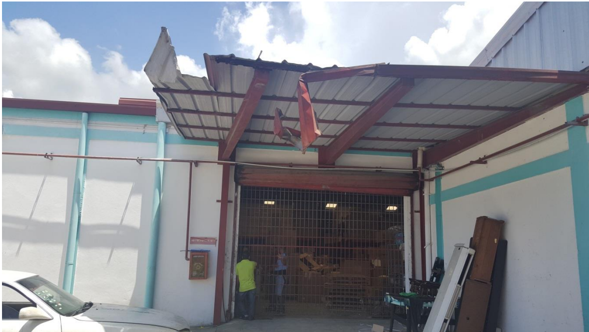
Parte de una cornisa semi desprendida, La Novia de Villa, S.A., junio 2019.
