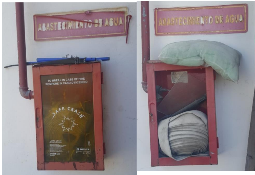
Estado actual manguera contra incendios, La Novia de Villa, S.A., junio 2019.
