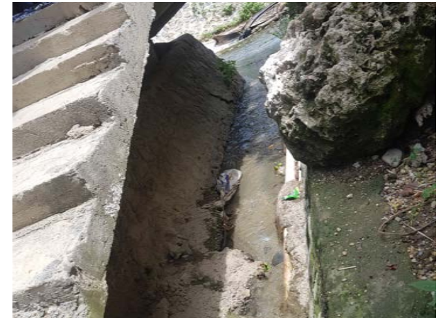
Imagen 175. Vivienda en mal estado.
