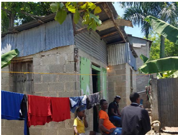
Imagen 164. Vivienda en mal estado.
