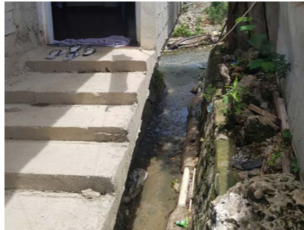
Imagen 174. Vivienda en mal estado.
