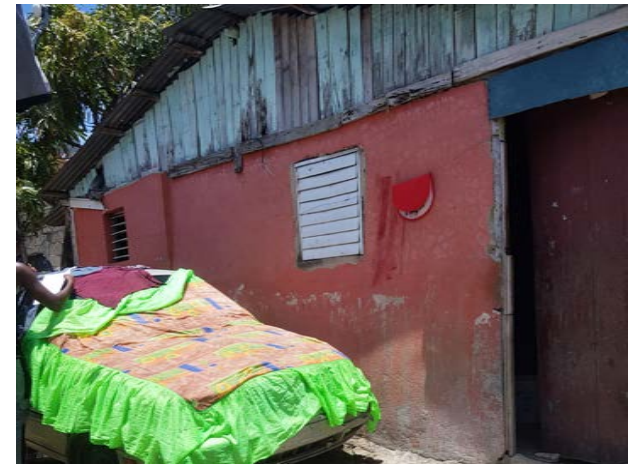
Imagen 183. Vivienda en mal estado.
