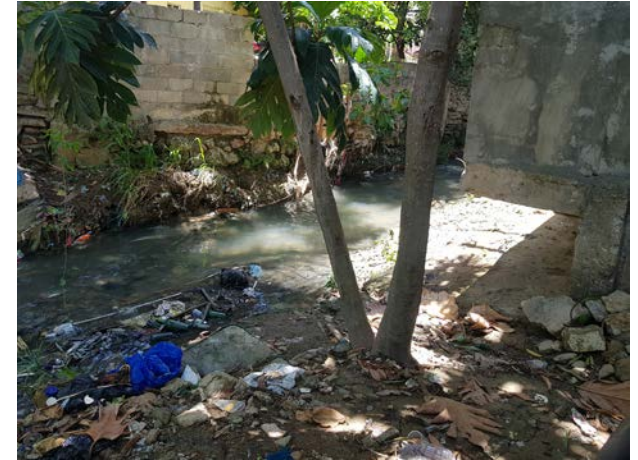
Imagen 145. Mal estado de el Arroyo
