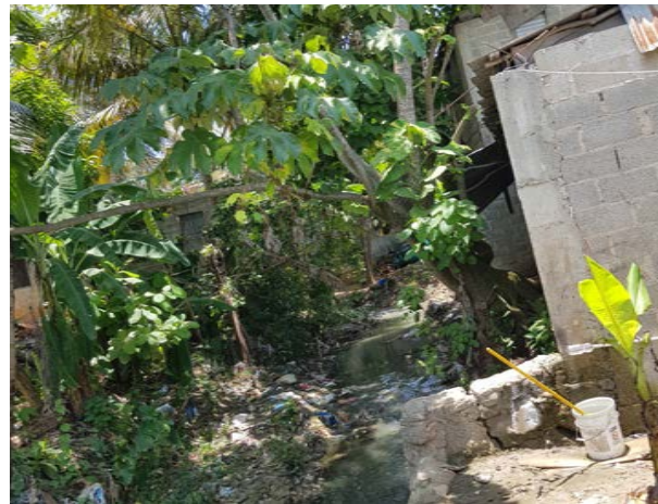
Imagen 182. Vivienda en mal estado.
