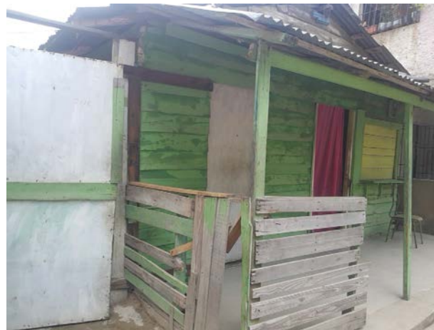
Imagen 156. Vivienda en mal estado.
