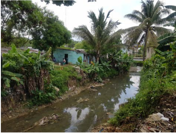
Imagen 152. Mal estado de el Arroyo.
