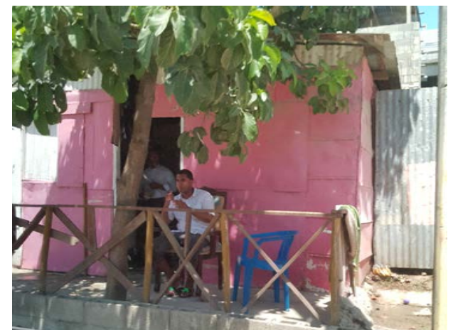
Imagen 169. Vivienda en mal estado.
