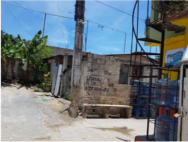
Imagen 179. Vivienda en mal estado.
