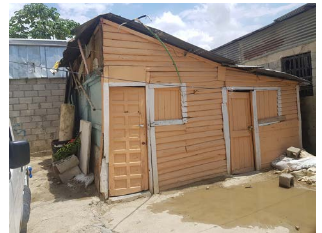
Imagen 157. Vivienda en mal estado.
