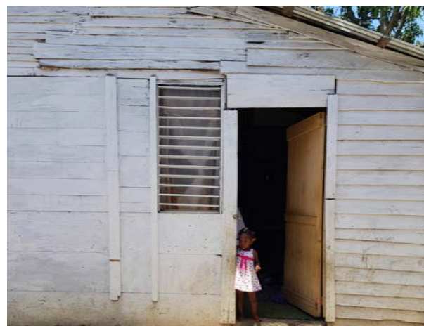
Imagen 168. Vivienda en mal estado.
