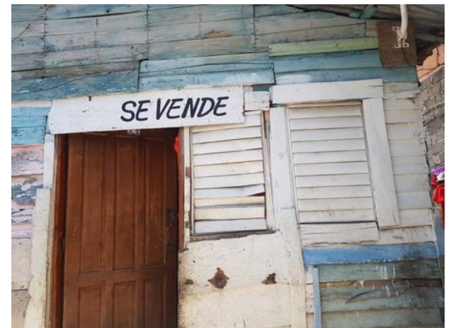
Imagen 166. Vivienda en mal estado.
