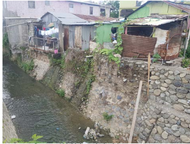
Imagen 120. Mal estado de el Arroyo y sistema de desagüe.
