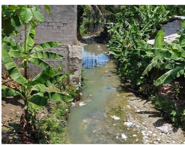
Imagen 140. Mal estado de el Arroyo.
