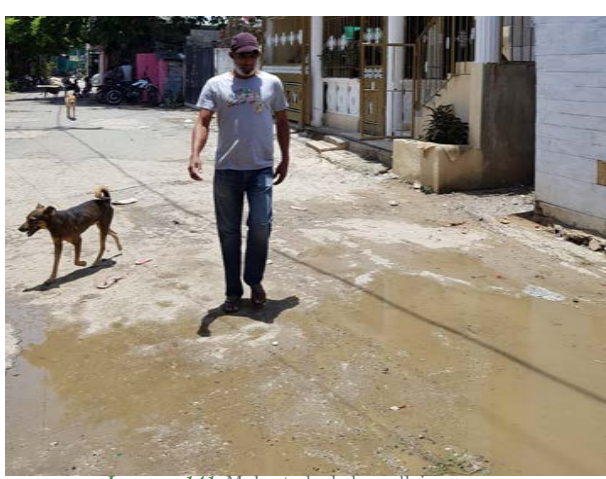
Imagen 141. Mal estado de los callejones.
