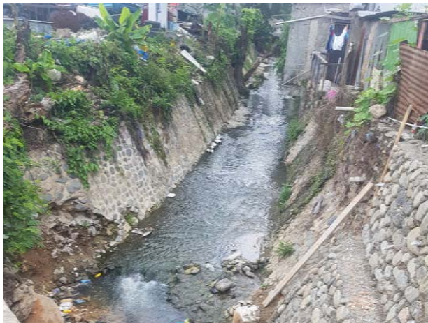
Imagen 122. Mal estado de el Arroyo
