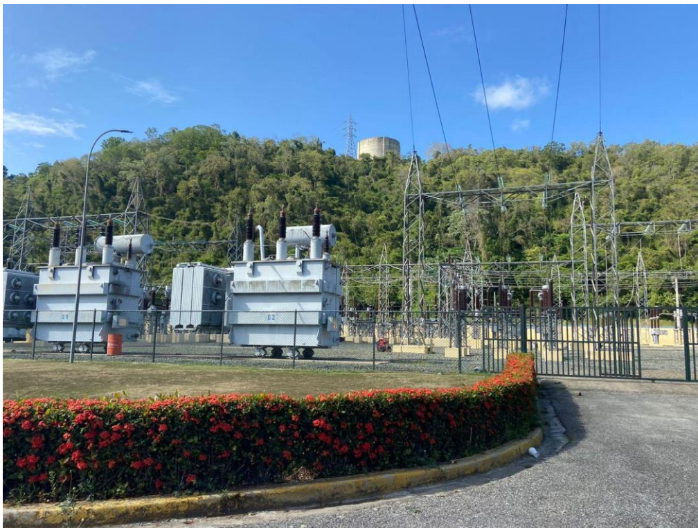
Ilustración 38: Central eléctrica de la hidroeléctrica de Tavera (Fuente: Propia 2021)
