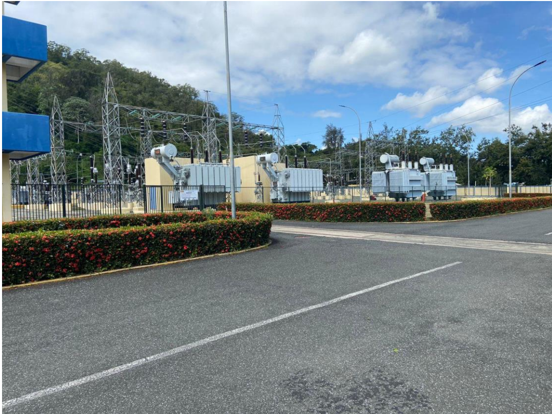
Ilustración 39: Central eléctrica de la Hidroeléctrica de Tavera (Fuente: Propia 2021)
