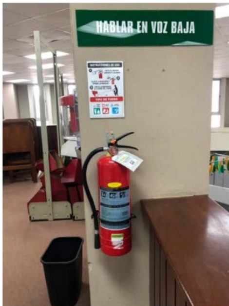
Figura 12. Fotografía tomada en la biblioteca, señalización de uso y extintor contra incendio ubicada en el piso 2 de la Biblioteca.
