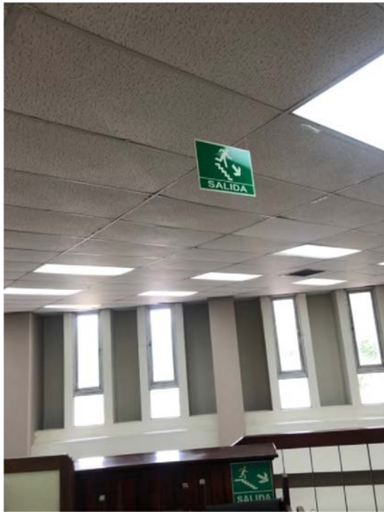
Figura 13. Fotografía tomada en la biblioteca, Señalización salida de emergencia ubicada en el piso 2 de la Biblioteca
