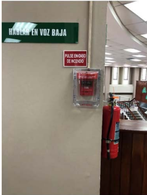
Figura 11. Fotografía tomada en la biblioteca, alarma contra incendio ubicada en el piso 2 de la Biblioteca
