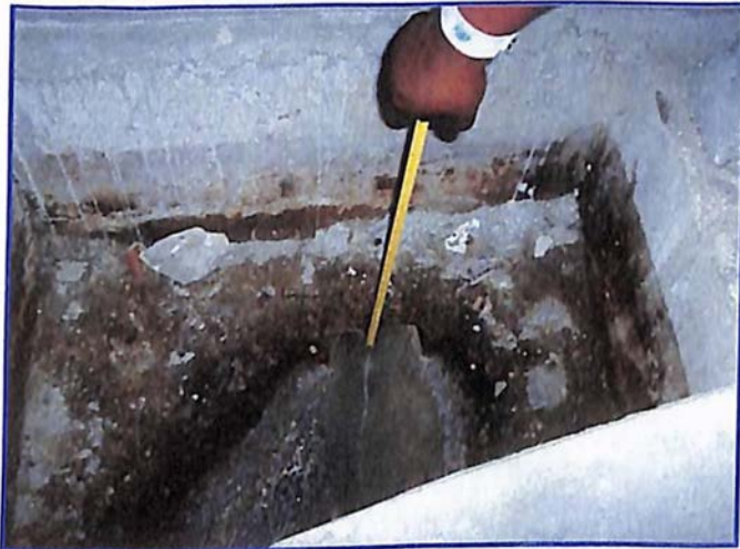
Medición de caudales en Registro Cocina-Restaurant
