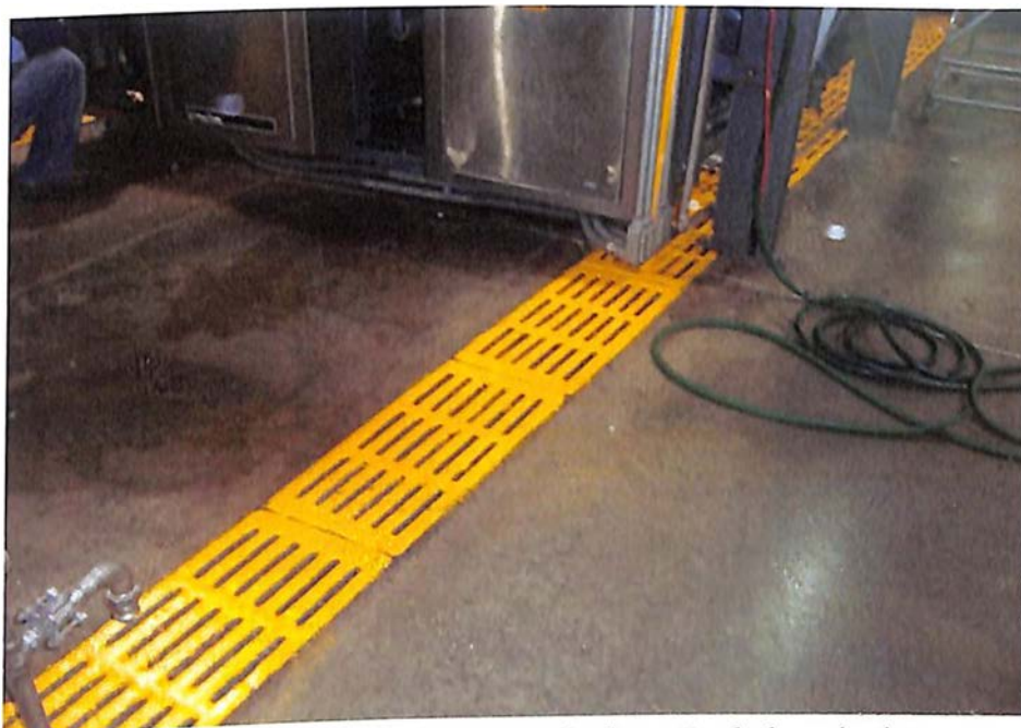
Figura34: Arreglo del sistema de desagüe de la máquina
