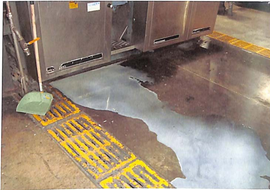
Figura33: Sistema de desagüe averiado. Antes
