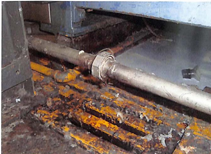
Figura 3: Canaletas de desagüe contaminadas y obstruidas.
