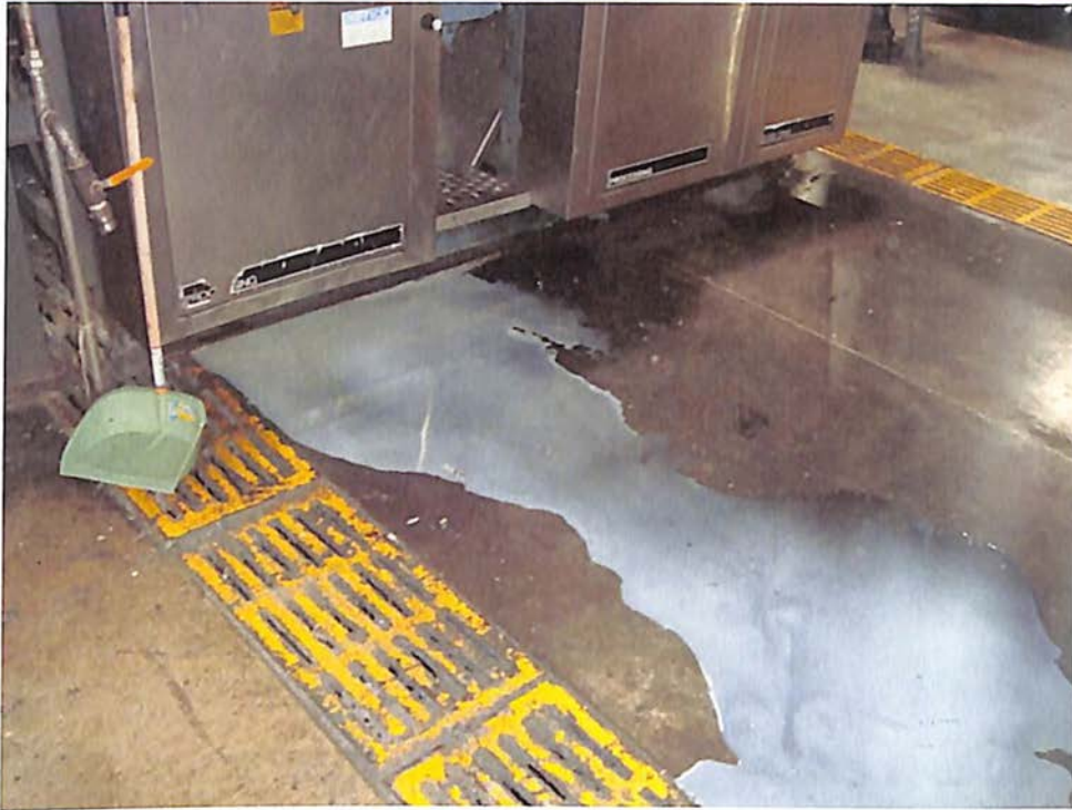
Figura 4: Sistema de drenaje averiado.
