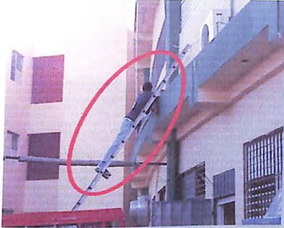
Mantenimiento sin protección
