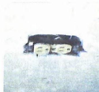
Figura 4: Tomacorriente sin tapa.
