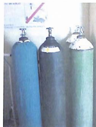
Figura 3: Tanques de oxígeno en condiciones incorrectas.
