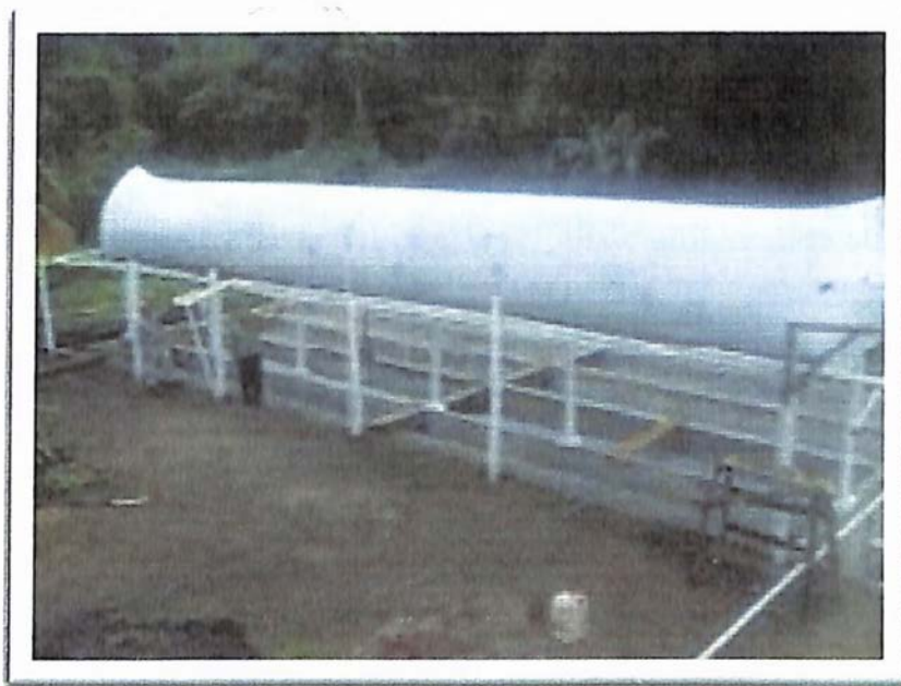
Imagen 3. Biodigestor la Yaguiza San Francisco de Asís
