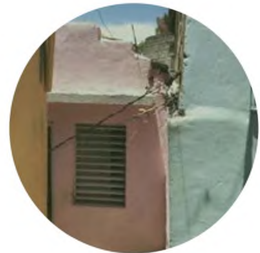
39. Casas en mal estado. Fuente propia.
