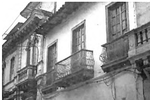
Figura 10 Ambato. Casa particular derrocada, calles Martínez y Bolívar. Detalle de la fachada con muro de adobe en planta baja y bahareque en planta alta, fotografiada en 1970 (Holguín 2009)
