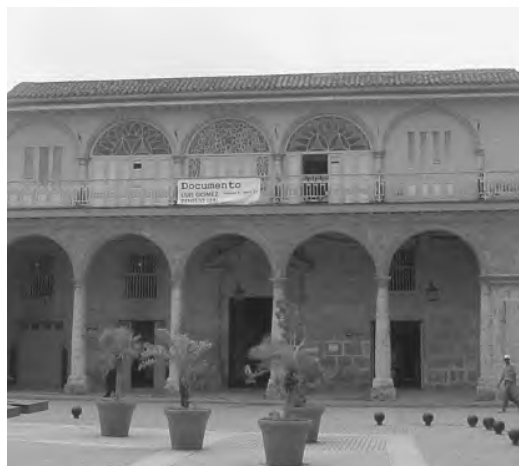
Figura 6 Fachada después de pasados 20 años de su restauración. (Archivo Histórico de la Oficina del Historiador de La Habana)
