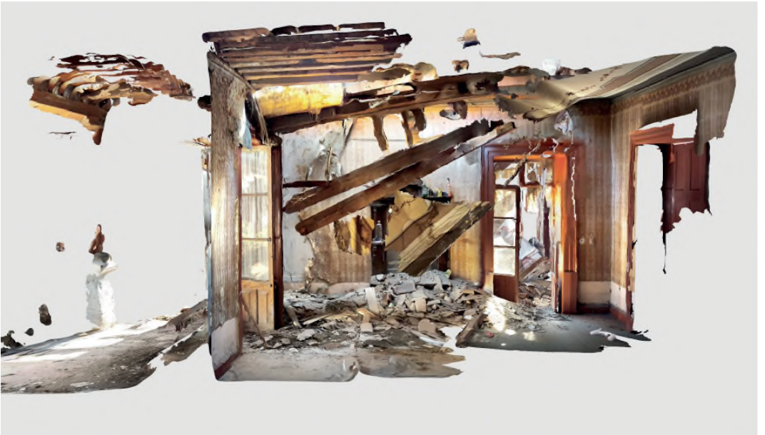
Figura 4 Escaneo LiDAR vista lateral del derrumbe principal y del cual se obtuvo la mayoría de información para detallar los principales sistemas constructivos. (Aarón Durán 2022)
