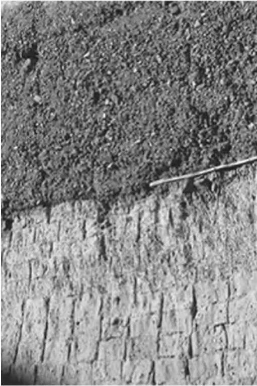
Figura 1 Tierra apilada sobre un muro de adobe
