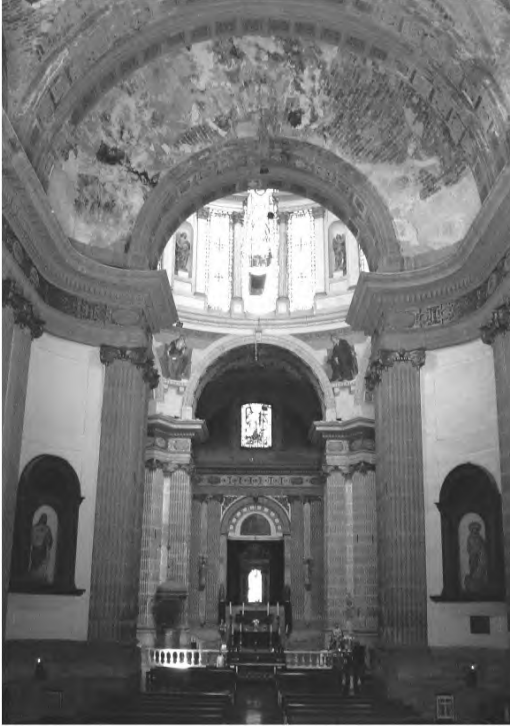
Figura 8 Esta imagen del intradós de la bóveda de transición, es una clara evidencia que la plementería es de ladrillo
