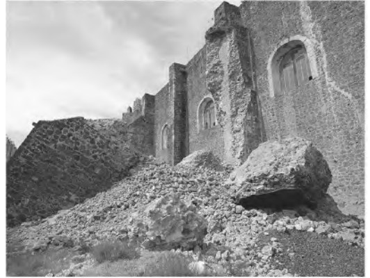
Figura 3 Ex-Convento de San Juan Bautista, Tlayacapan, Morelos. Colapso de contrafuerte fachada sur, daño estructural grave del dispositivo de defensa ampliado, ante empujes propios y debido a terremotos. (Hernández Eumelia, 2018)
