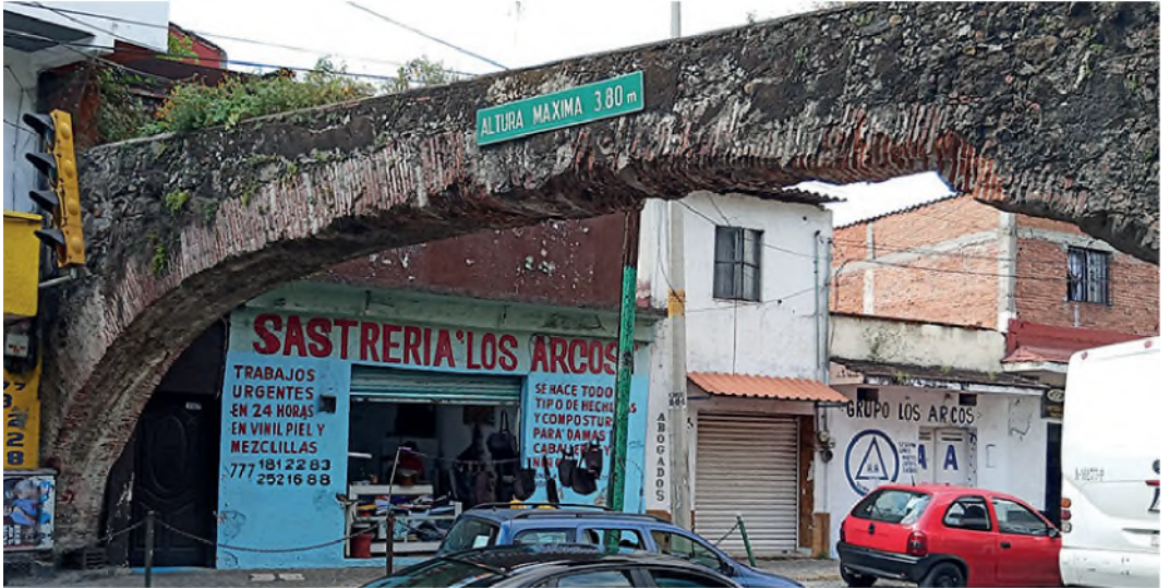
Figura 8 Daños en el arco carpanel
