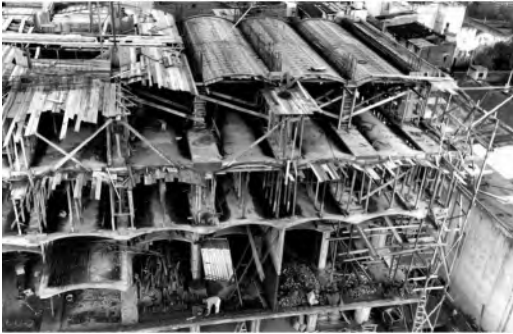
Figura 13 Galería Rivadavia. Bóvedas-jácena de hormigón armado en construcción. (Archivo Antoni Bonet Castellana. Archivo Histórico el Colegio Oficial de Arquitectos de Cataluña)
