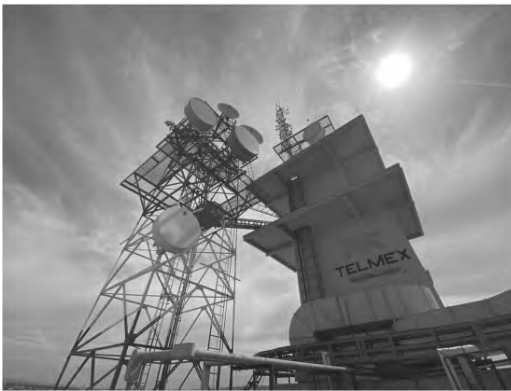
Figura 8 Equipos especializados de la compañía Telmex (Archivo de J. Jesús López García)
