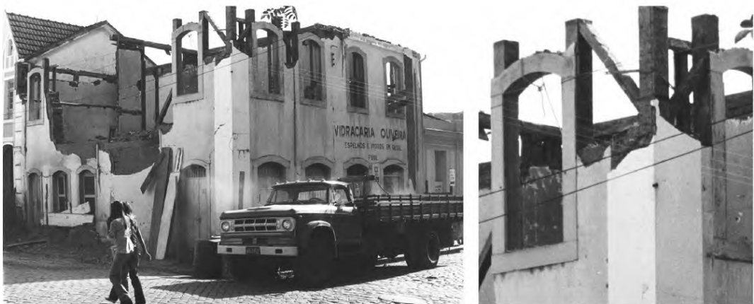
Figura 7 Fotografia de sobrado em demolição (fotografia e detalhe ampliado) na antiga Rua da Intendência. (São João del-Rei, data e fonte desconhecidas)
