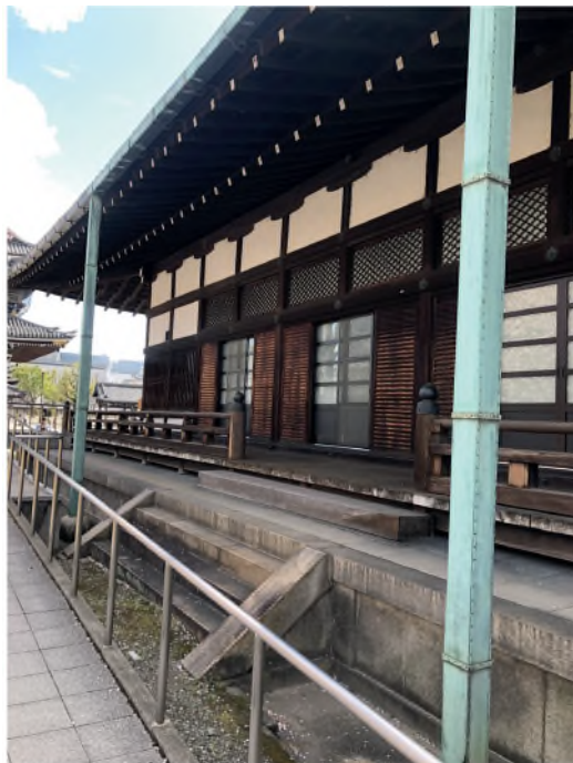
Figura 2 Detalle de las bajadas de agua pluvial hacia el canal de captación perimetral en los templos budistas de Higashi Hongan-Ji en Kioto Japón, fotografía. (Pastrana 2023)
