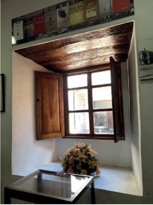
Figura 5 Ambato. Casa de Montalvo. Vano con dintel de madera en un muro de adobe (Foto del autor 2021)
