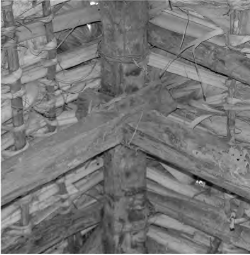
Figura 3 Tirantes en una edificación de tabla de palma (Flores Sasso 2007)
