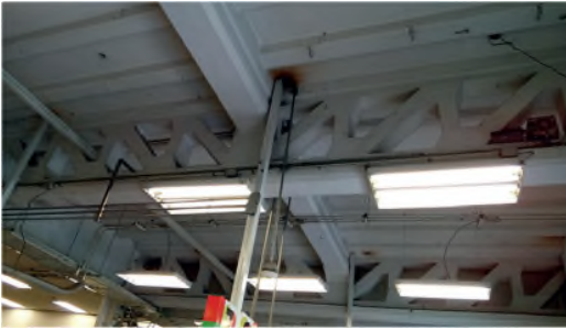
Figura 4 Vista de la estructura prefabricada de concreto armado a base de columnas, traveses y losas en el área comercial de la Ex ferretería Ritter & Bock (Archivo Arturo Román).
