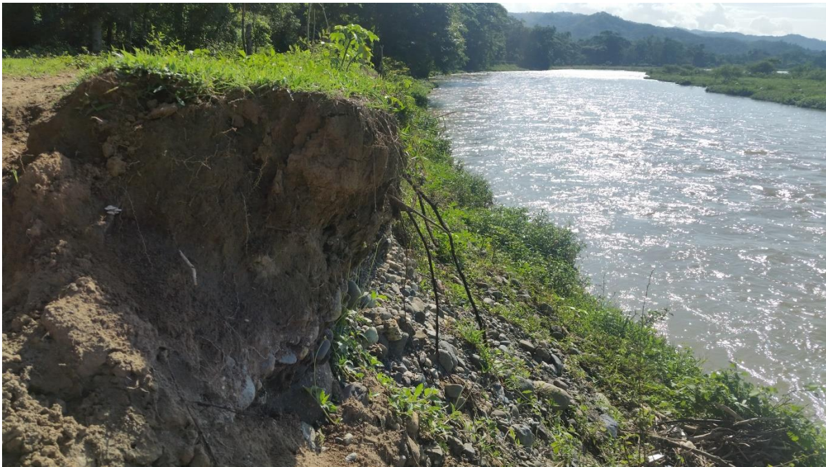
Figura 25: Ribera Erosionada tramo objeto de estudio. Fuente: Propia. Rio Yuna, Bonaó, 2016.
