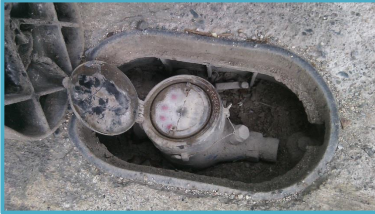
Ilustración 4: Medidores en mal estado Fuente: Propia
