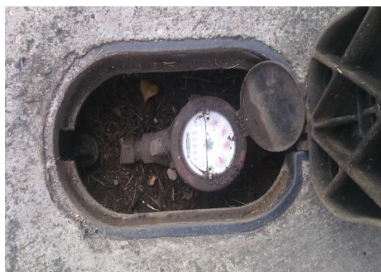
Ilustración 12: Medidor de agua Potable Fuente: Propia
