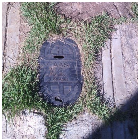
Ilustración 10: Caja de medidor de agua Fuente: Propia
