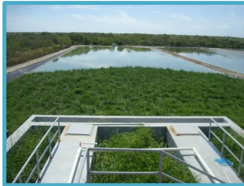
Ilustración 7: Planta de tratamiento de aguas residuales con Macrofitas Punta Cana, Fuente: (AGUA INC, 2013)
